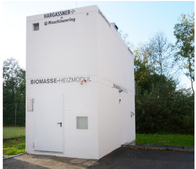
Nahwärmeversorgung Maschinenring in Weng, 150 kW Hackgut
