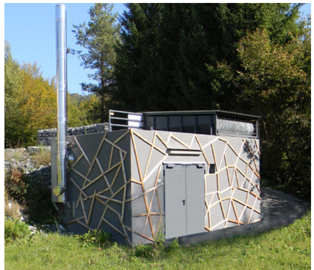
Regionalwärme Rosental (Contracting) in Ludmannsdorf, 200 kW Hackgut
