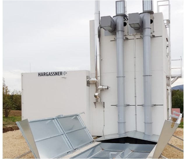
Bioenergie Gnadendorf, 2 x 120 kW Hackgut
