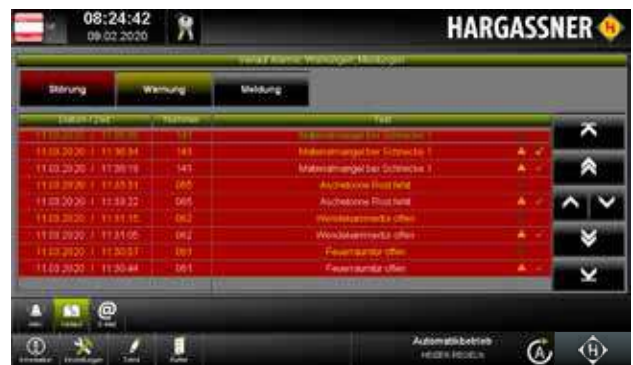
Enregistrement continu pour la surveillance et la maintenance
